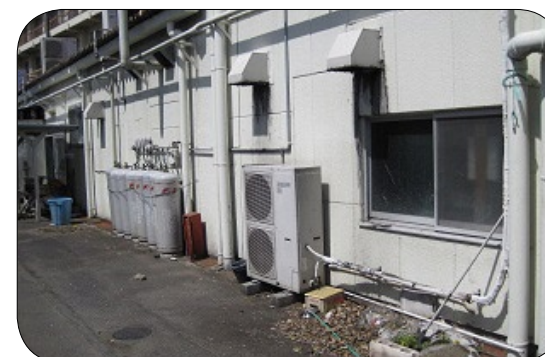
室外環境異常による配管の劣化
