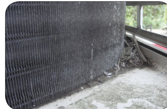
熱交換器下部の腐食
