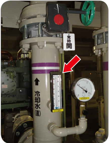
冷却水出口温度計確認
