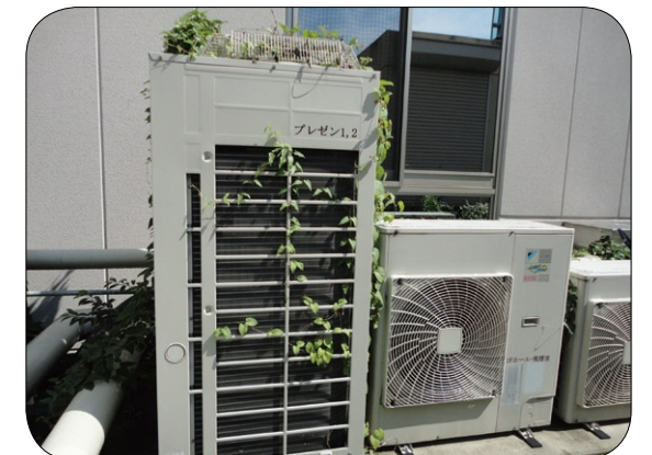
草で覆われた室外機
