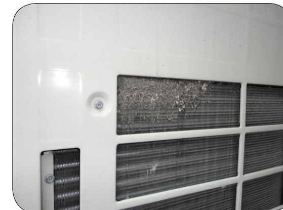
室外機に付着したゴミ
