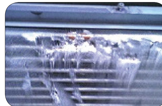
熱交換器表面の損傷
