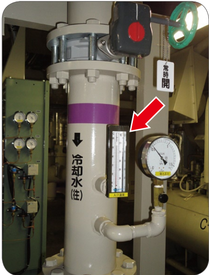
冷却水入口温度計確認
