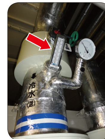
写真-D 冷水入口温度
