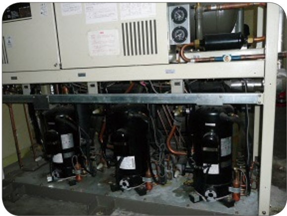
ユニット型冷凍機の異常振動確認
