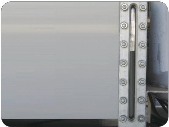
受液器液面計の液面位置
