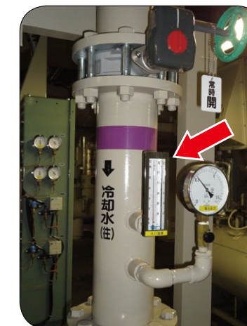
写真-E 冷却水入口温度
