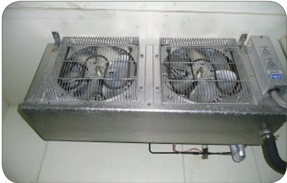
冷蔵庫内正常な冷却器外観
