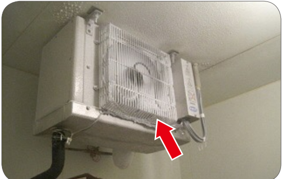
冷却器の内部霜付き異常
